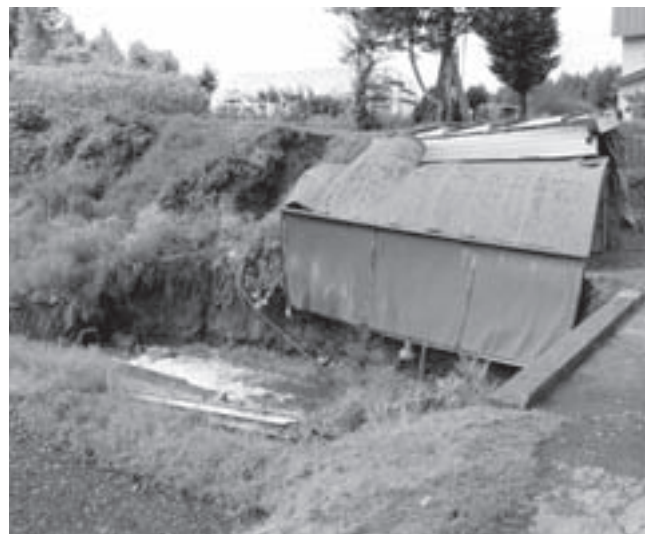
大成川の護岸崩落
