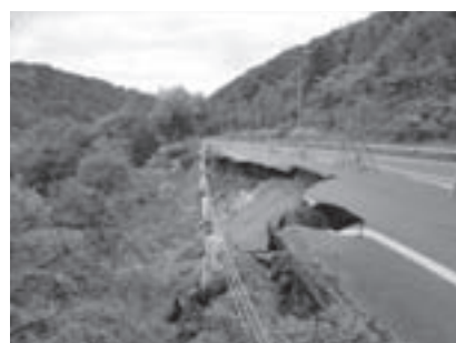
福原 道道の路肩崩壊
