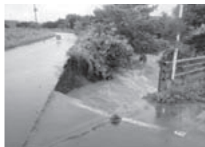
西和11線川 護岸崩落
