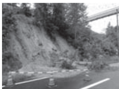
三笠山2号道路 法面崩落
