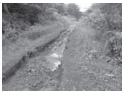
大成連絡道路 路面洗掘
