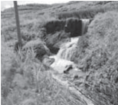
大成 水田の法面崩落
