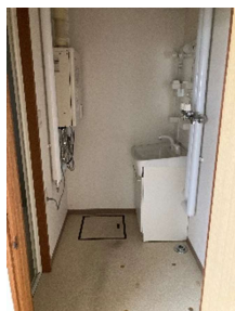
脱衣所（給湯ボイラー）
