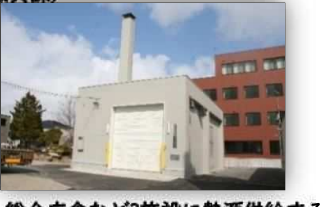
総合庁舎など3施設に熱源供給する 木質チップボイラー
