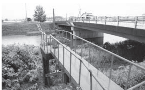
▲内水氾濫の危険性を含んでいた樋門（寒川橋横）
