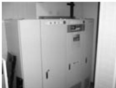
▲病院に備え付けの大型蓄電池
