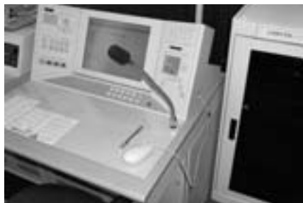
▲防災無線の放送設備
