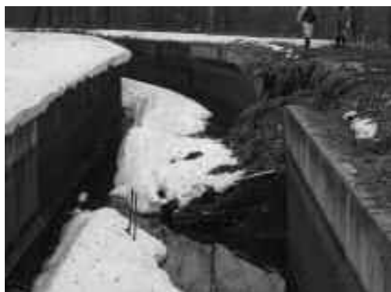
▲自然災害による破損（剣和幹線）
