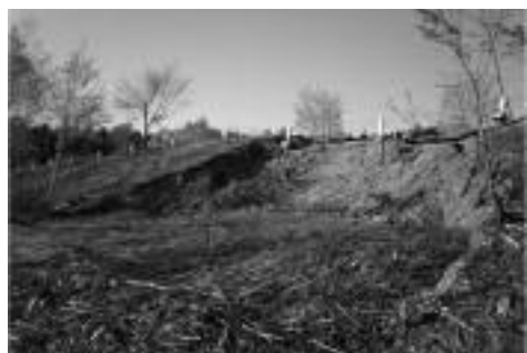
▲塩狩南丘線の法面の崩壊状況
