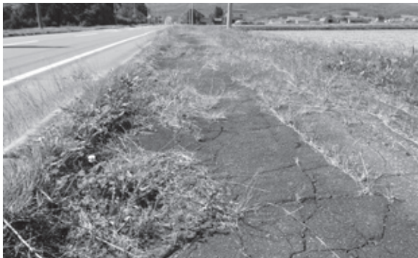
▲割れた道路に繁茂する雑草
