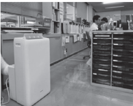
▲試験導入しているスポットクーラー（左側）
