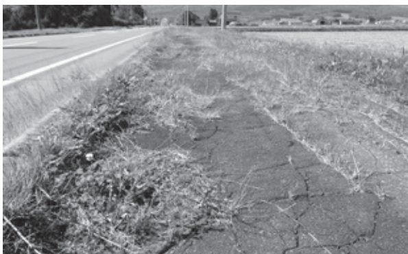
▲割れた道路に繁茂する雑草
