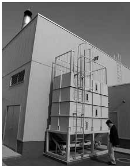
子供センターのペレットタンク
