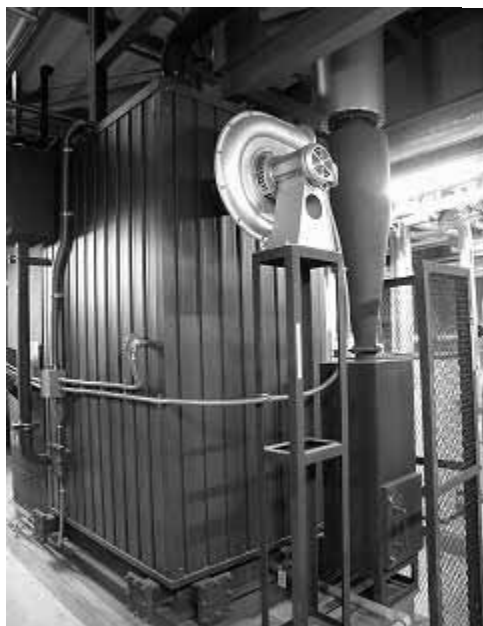
子供センターのペレットボイラー
