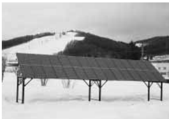
交流施設ひだまりに設置された太陽光パネル
